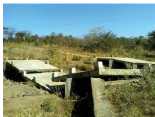
Figura 41 – Ponte Destruída pelas Chuvas
